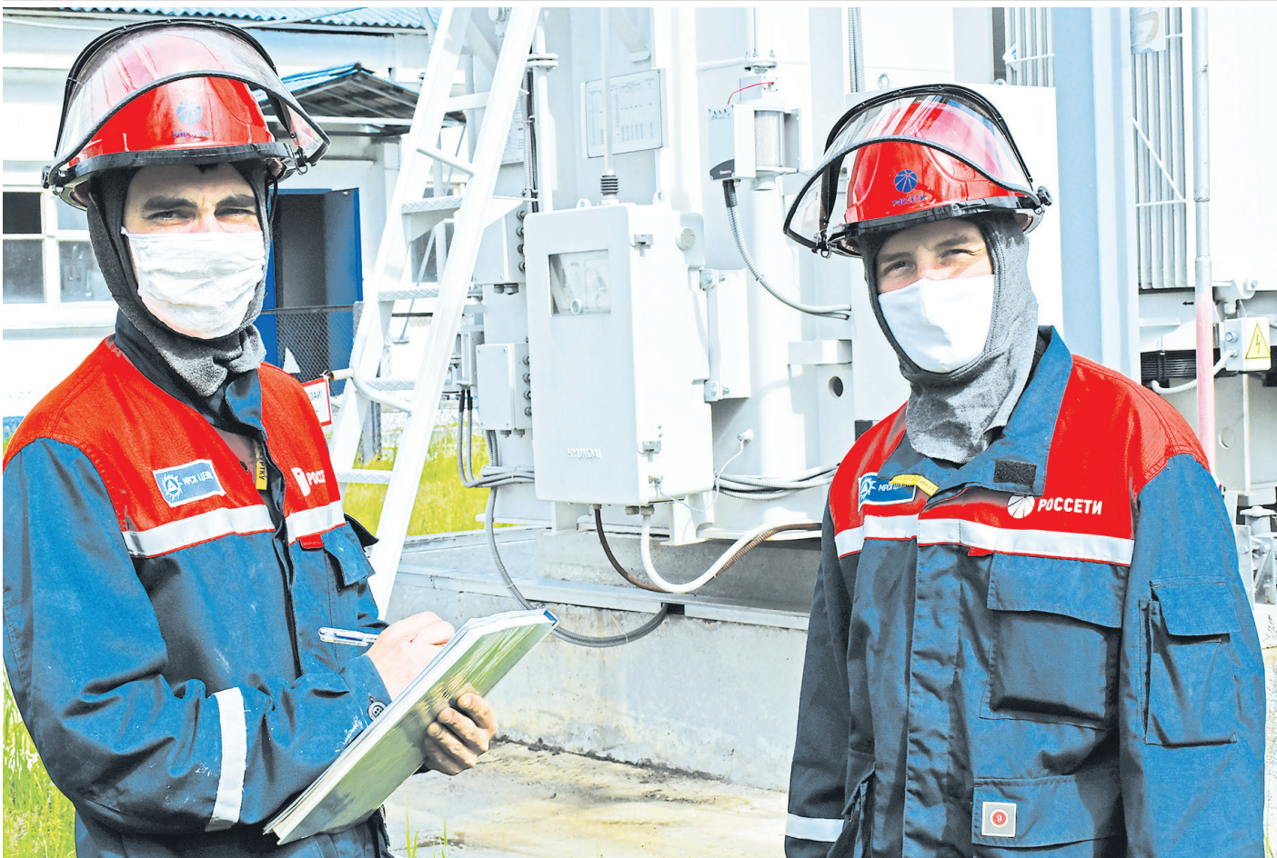
Электромонтёр оперативно-выездной бригады Александр Богун и электромонтёр электрических сетей Евгений Сыпко проводят диагностику оборудования подстанции 110/35/10 кВ «Борисовка»
