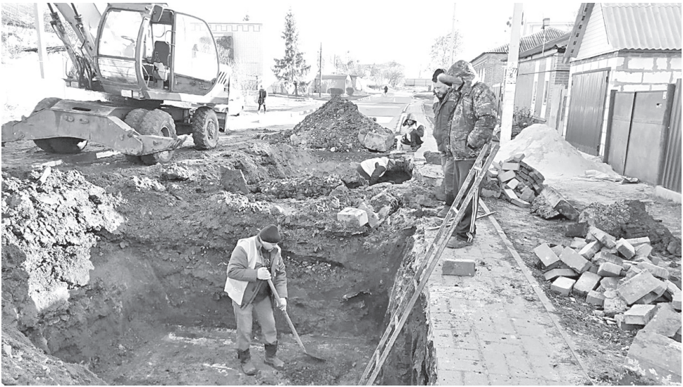
Работники АО «Борисовская теплосетевая компания» во время ликвидации аварии на тепло-трассе
